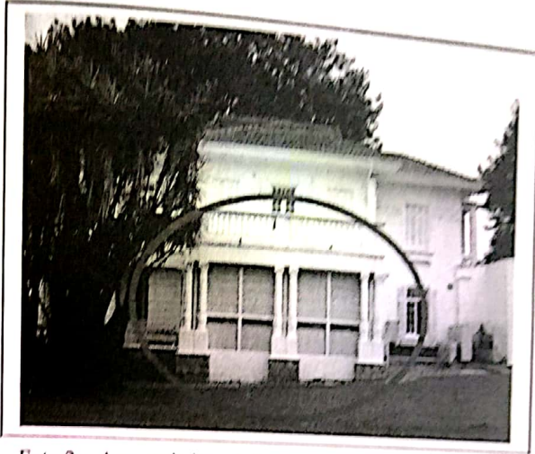
Foto 2 - A varanda lateral do pavimento térreo que foi vedada com vidros posteriormente ao casarão deverá contemplar suas características originais, devendo a mesma ser aberta.
