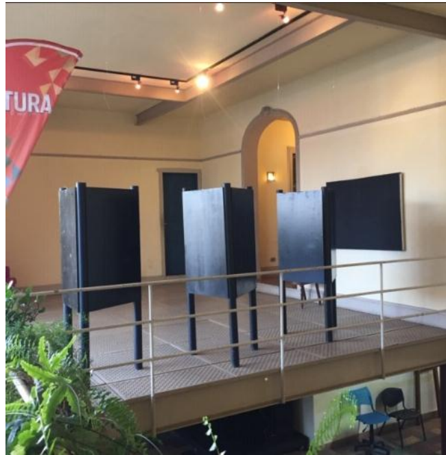
Guarda-corpo fora da Norma – Registro fotográfico 04.07.2022
