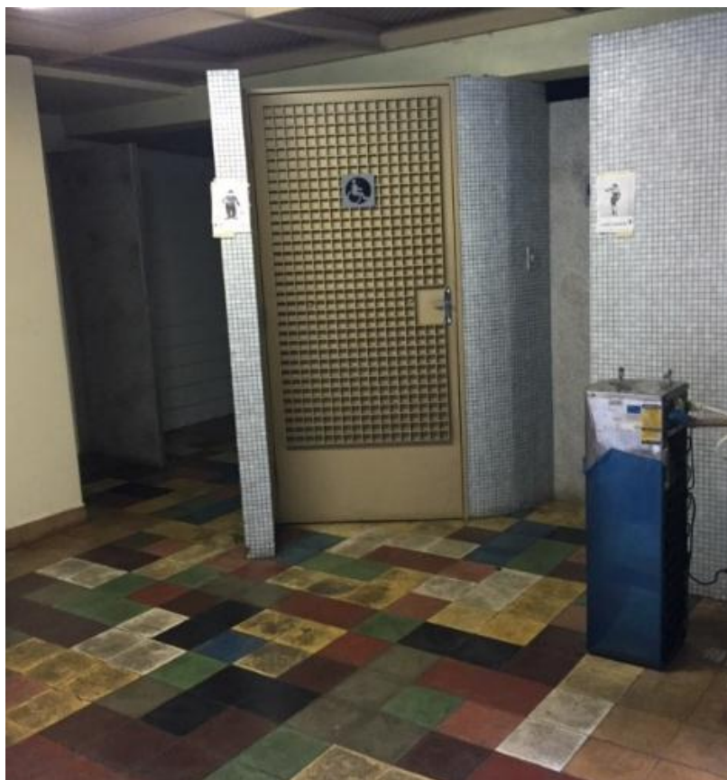
Entrada dos WC's – Registro fotográfico em 04.07.2022
