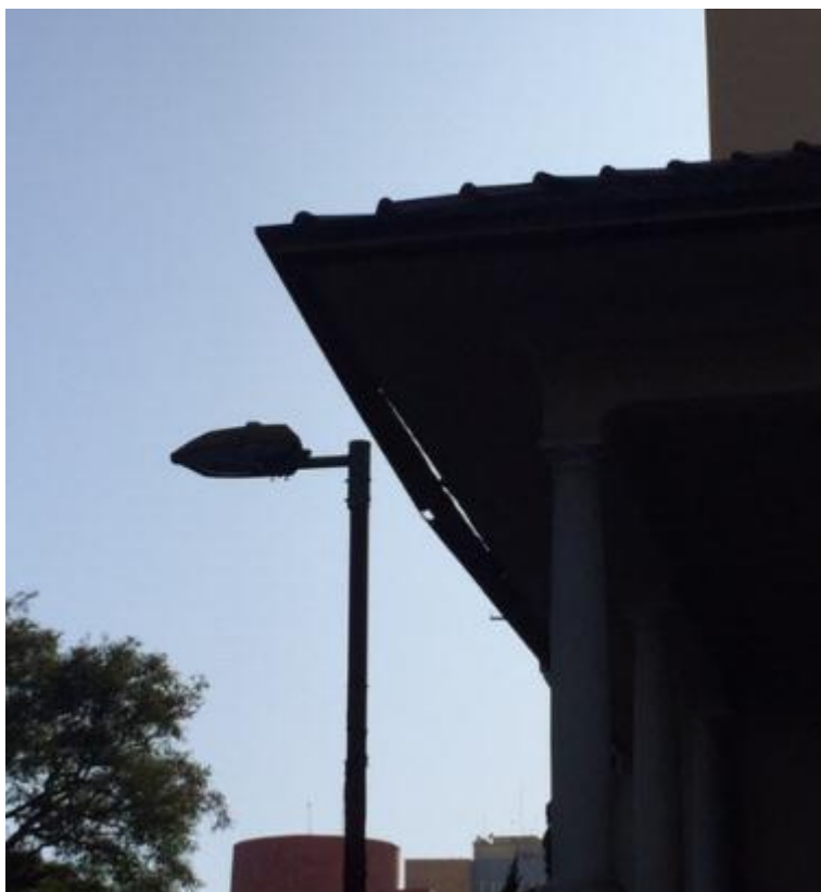
Calha destacada da estrutura do telhado. Registros fotográficos em 04.07.2022.
