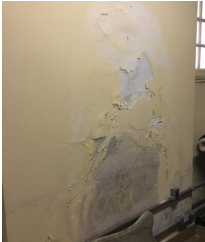
Umidade ascendente nas paredes – Registro fotográfico 04.07.2022
