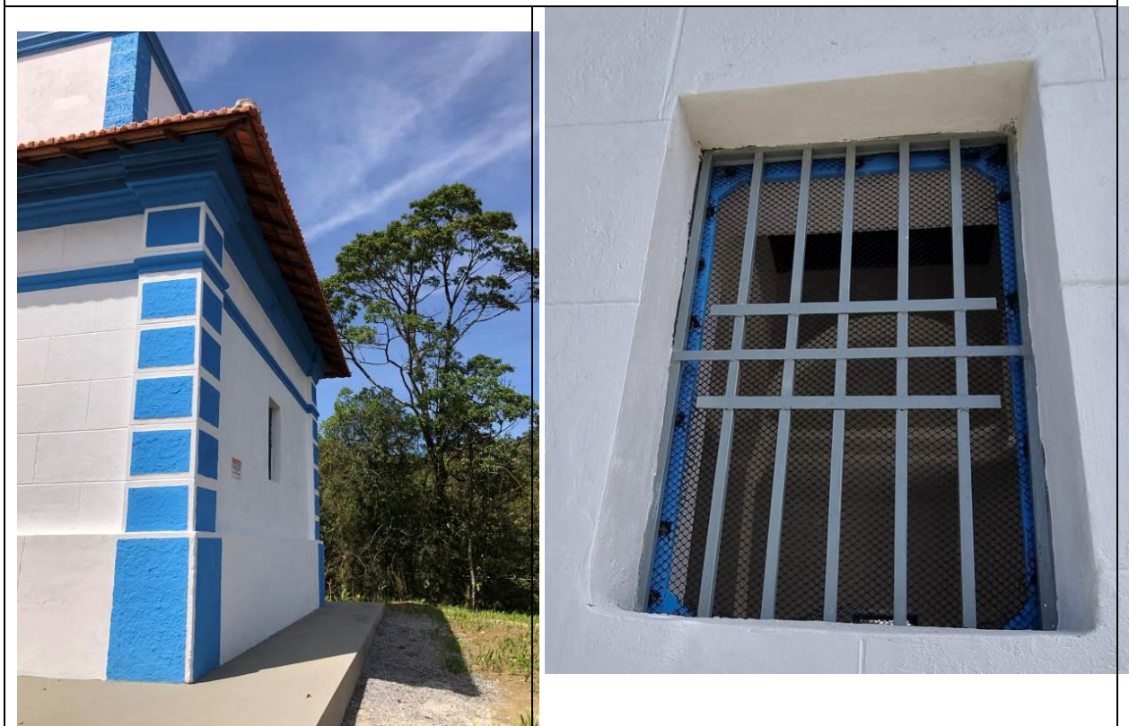
Foto 4 e 5 – Detalhe da fachada lateral e detalhe do gradil refeito. Foto Suzana Kleeb, 19.09.2022.
