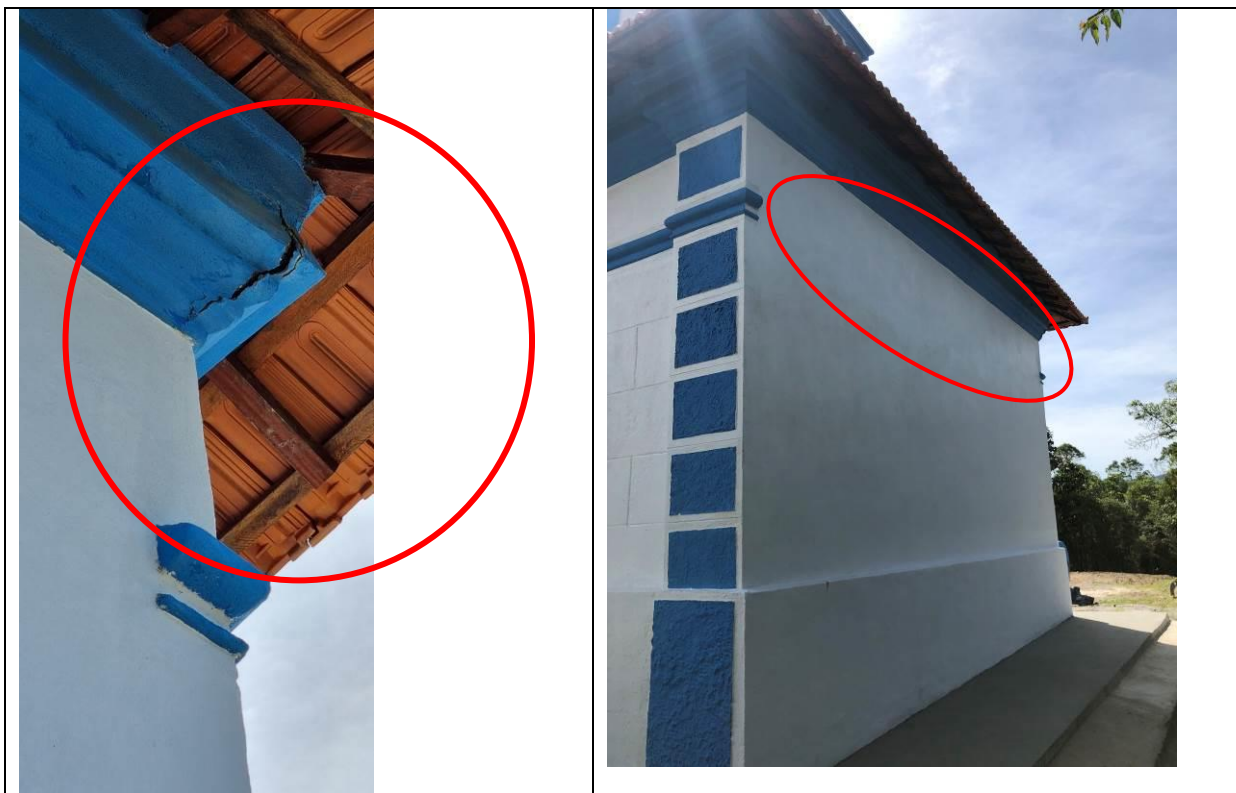
Foto 2 e 3 – Detalhe da rachadura existente na fachada posterior, notar que o friso não existe. Foto Suzana Kleeb, 19.02.2022.
