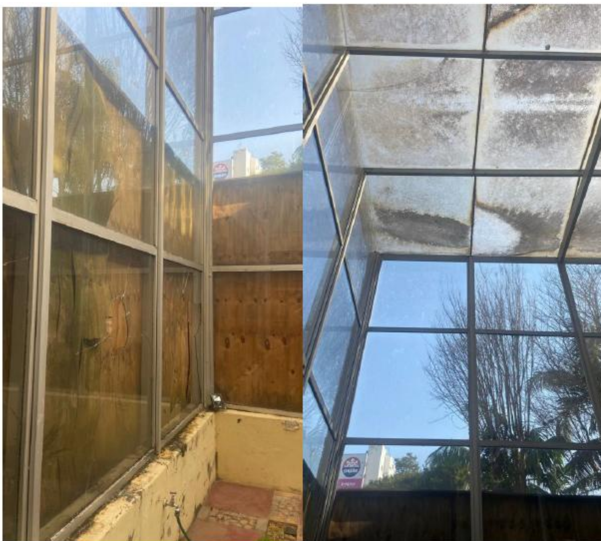
Foto 6 e 7 – Vista de dentro do foyer – vidros quebrados e toda estrutura degradada
