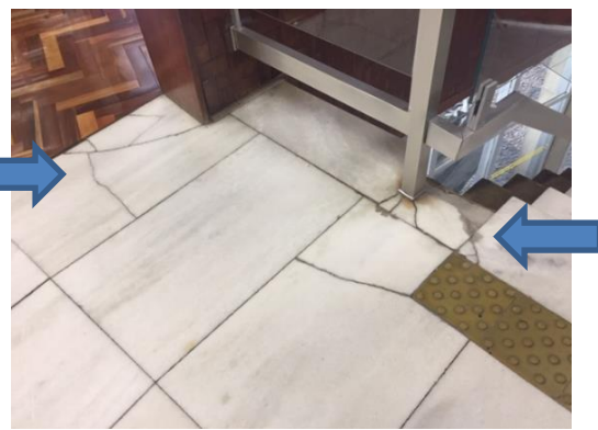
Piso patamar escada (trincas) e piso tátil - Foto 04
