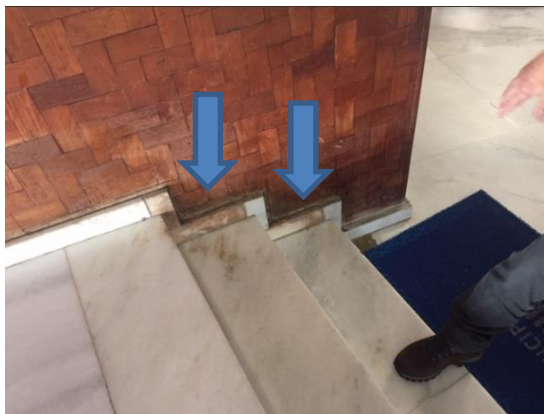
Rodapé escada (manchas) - Foto 09
