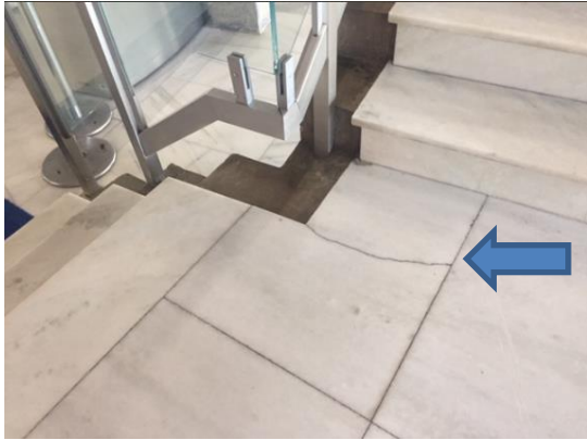
Piso patamar da escada (trinca) - Foto 08
