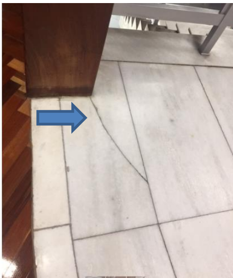
Piso patamar escada (trincas) - Foto 05
