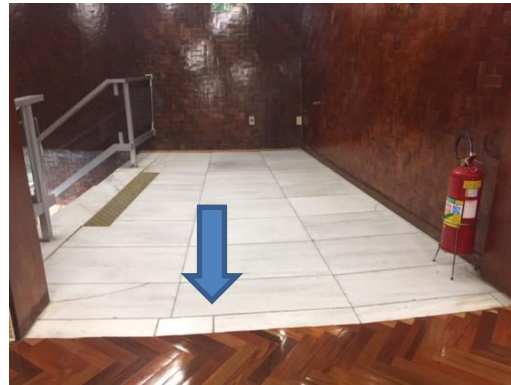
Piso patamar escada (trincas) Foto 02
