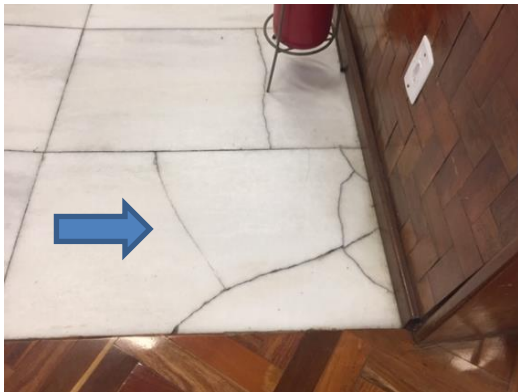
Piso patamar escada (trincas) - Foto 03
