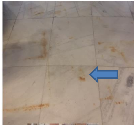
Saguão – piso com manchas - Foto 12
