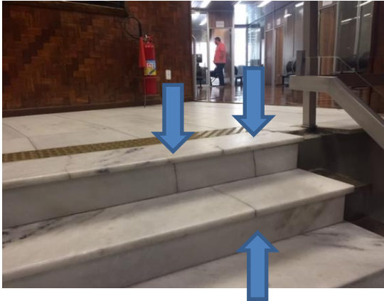
Piso e espelho degrau escada (trincas) - Foto 07
