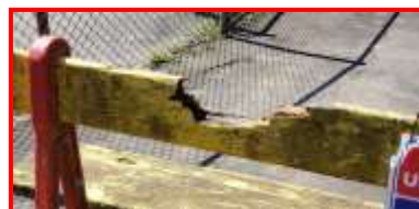
Foto 08: Detalhe da peça danificada do banco, 16.11.2021.
