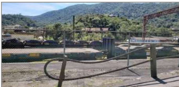
Foto 01: Vista dos cabos metálicos afrouxados, resultantes de despregamento de peças estruturantes do conjunto do guarda corpo, 16.11.2021.
