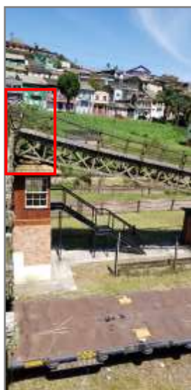
Foto 02: detalhes de cabos metálicos parcialmente soltos de pilarete em vias de cair, 16.11.2021.
