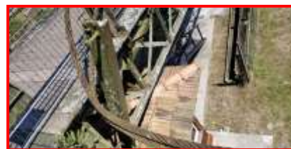
Foto 03 e 04: detalhes de pilarete metálico em vias de cair, 16.11.2021.
