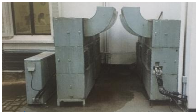
Imagem condensadora de ar condicionado – Foto – Fls. 101
