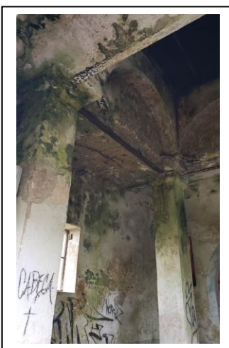
Foto 20. Interior da capela com estruturas em ferro aparentes, bolor e marcas de umidade. 09.06.2021.
