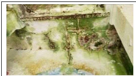
Foto 22. Interior da capela com marcas de umidade, fissuras e bolor nas paredes, e ferrugem nas estruturas metálicas da edificação. 09.06.2021.
