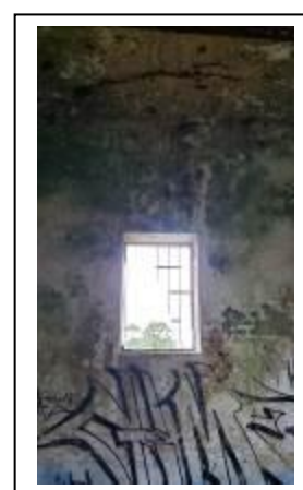
Foto 21. Interior da capela, com perda de gradil de janela, pichações e marcas de umidade. 09.06.2021.
