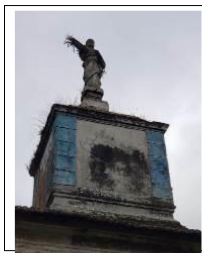
Foto 19. Estátua de Cristo Redentor com vegetação crescida em fissuras. 09.06.2021
