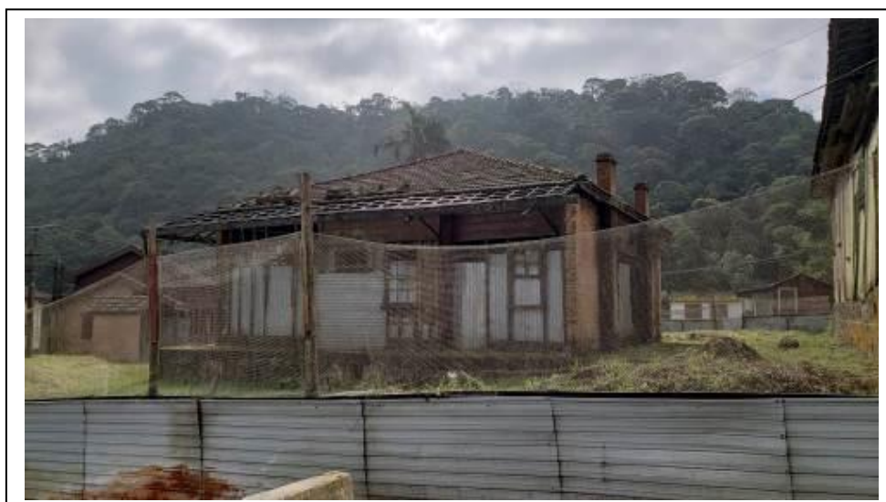
Foto 50. Vista do antigo grupo escolar de Paranapiacaba, em estado de conservação precário e, segundo placa, no aguardo de recursos para a realização das obras, 09.06.2021.
