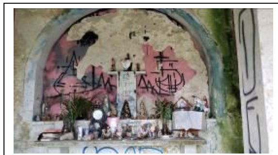
Foto 23. Altar no interior da capela, com despregamento da pintura e do reboco das paredes, pichações e introdução de diferentes tipologias de imagens. 09.06.2021.
