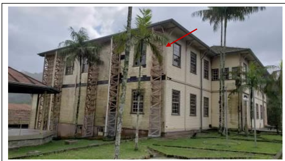
Foto 45. Vista da edificação sede do antigo União Lira Serrano, vendo-se obra de escoramento destacada com seta, 09.06.2021.
