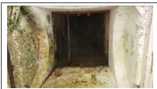
Foto 24. Detalhe interno da capela, no espaço de instalação da estrutura de apoio à estátua, com umidade, ferragens enferrujadas. 09.06.2021.
