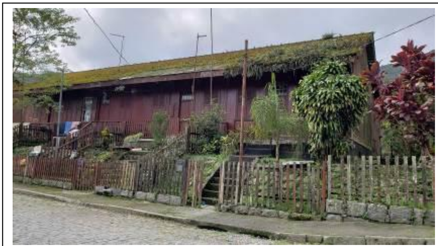
Foto 32. Vista do conjunto de edificações, Rua Alfredo Maia, 491, 493, 495. Vê-se que este telhado está aparentemente mais íntegro, mas com grande quantidade de vegetação nas bordas, 09.06.2021.
