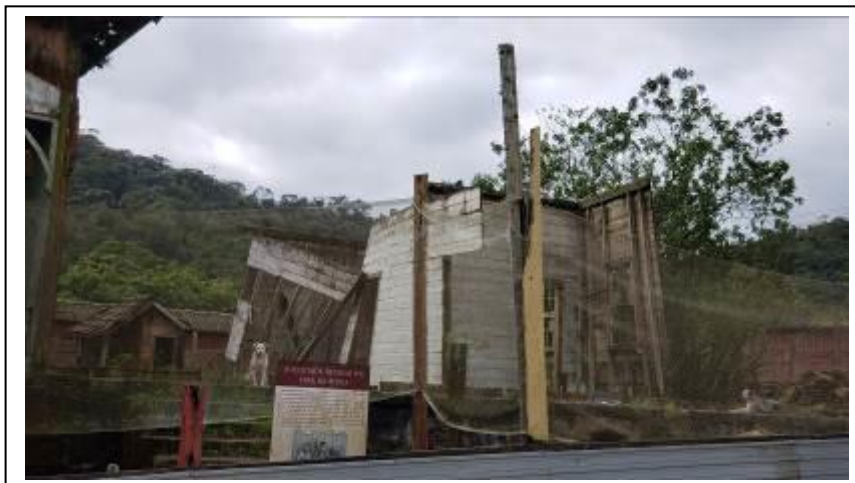
Fotos 47 a 49. Vistas do estado de conservação do complexo do Lyra da Serra, com destaque para a arruinação de parte do telhado (foto 47), da edificação lateral (foto 48) e da placa que indica a falta de verbas para a obra, 09.06.2021.
