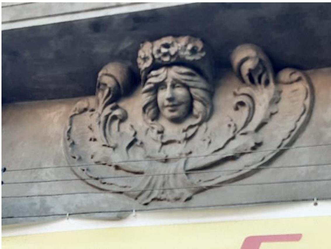
Imagem 20: Detalhe de execução de mascarão voltado para da Rua Bernardino de Campos
