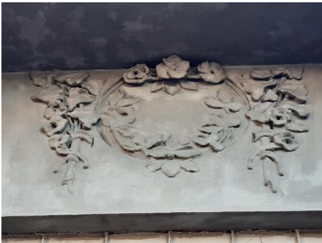
Imagem22: Detalhe de execução de guirlanda voltada para da Rua Bernardino de Campos
