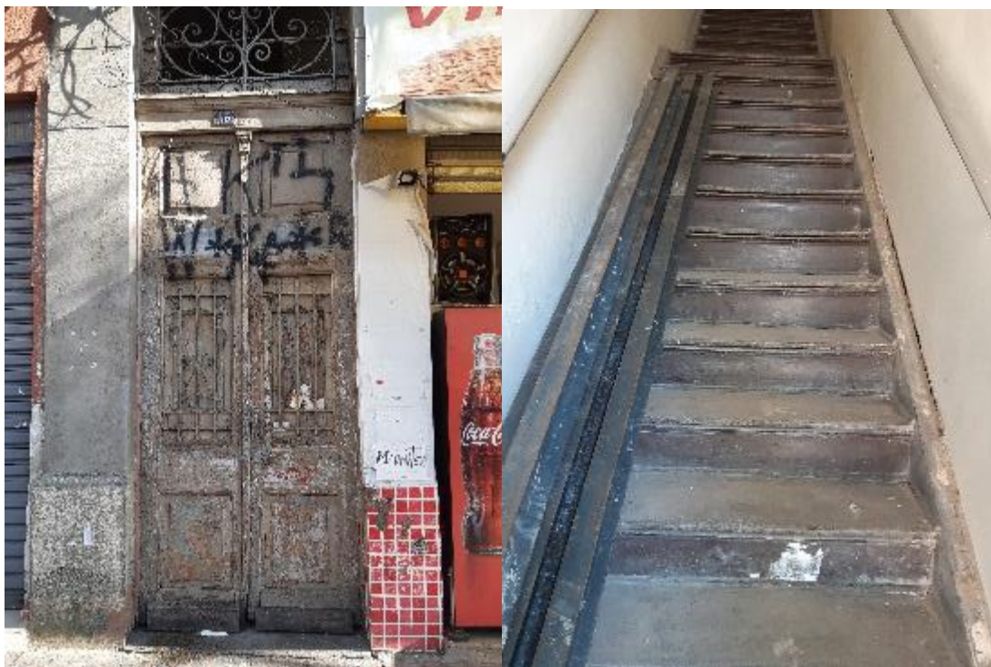
Imagens24 e 25: Detalhe de elementos de madeira a restaurar (porta principal e escada)
