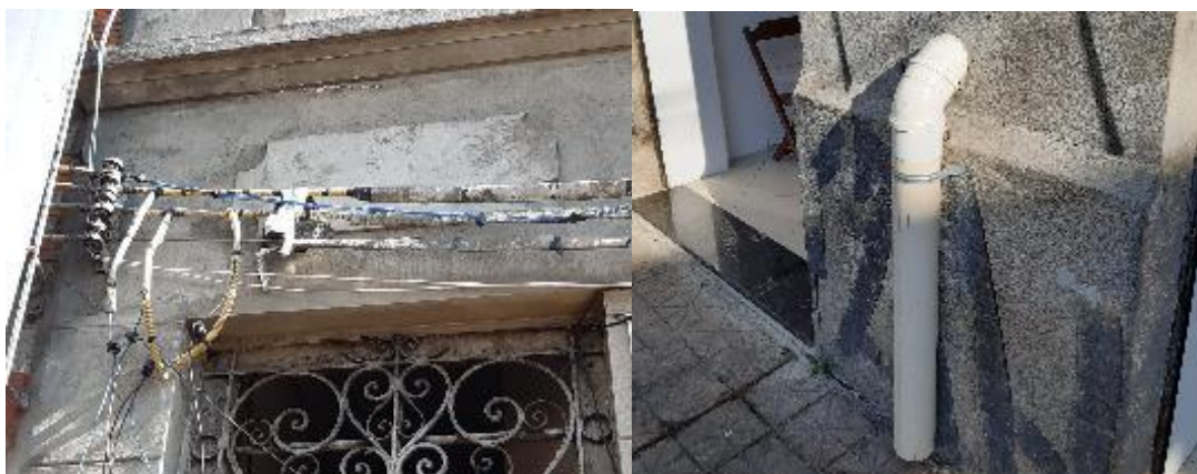
Imagens18 e 19: Detalhe de rede elétrica e de drenagem sobre a fachada da Rua Bernardino de Campos
