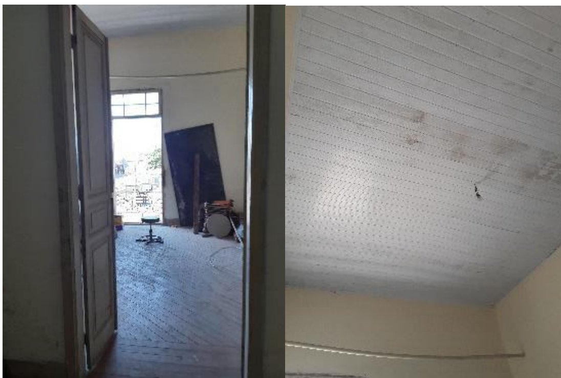
Imagens26 e 27: Detalhe de piso de madeira a restaurar e forro de madeira substituído por PVC
