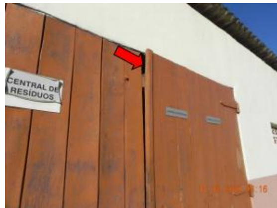
Porta de madeira desalinhada – ago/20
