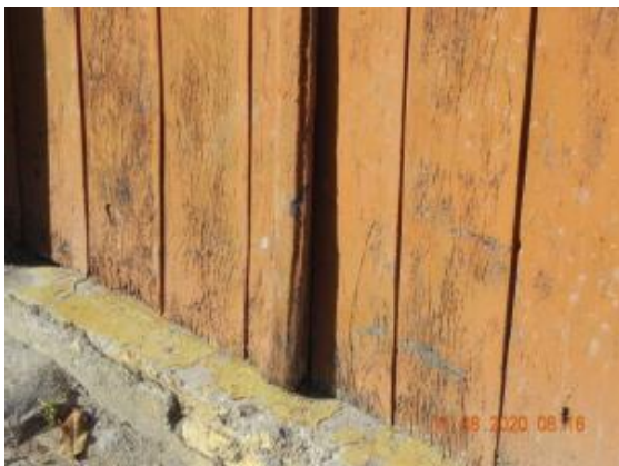
Portas de madeira com partes desgastadas – ago/20
