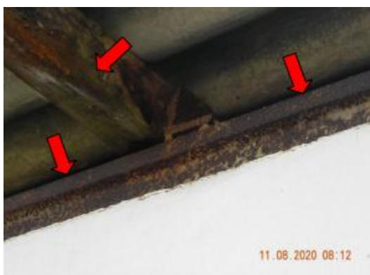
Viga trilho oxidada e viga madeira com provável probl.
