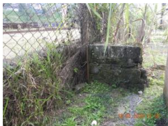
Muro e piso de pedra com presença de vegetação ago/20
