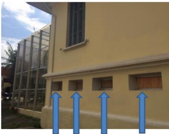
Foto 02 Janela do banheiro com fechamento provisório em madeira A estrutura da janela é em alumínio natural
