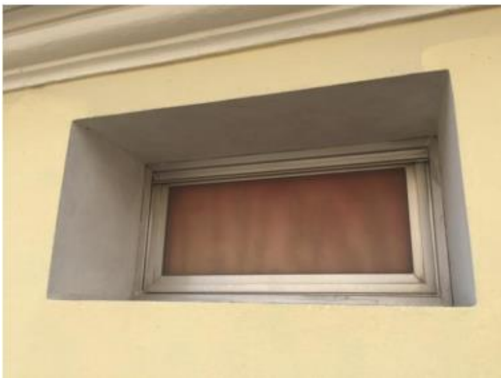
Foto 03. Estrutura em alumínio natural Grade na cor amarelo claro Os elementos metálicos existentes são na cor amarelo claro ou alumínio natural
