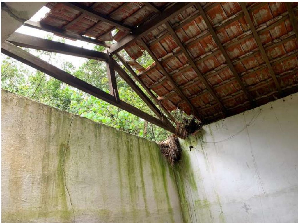
Problemas na estrutura do telhado.
