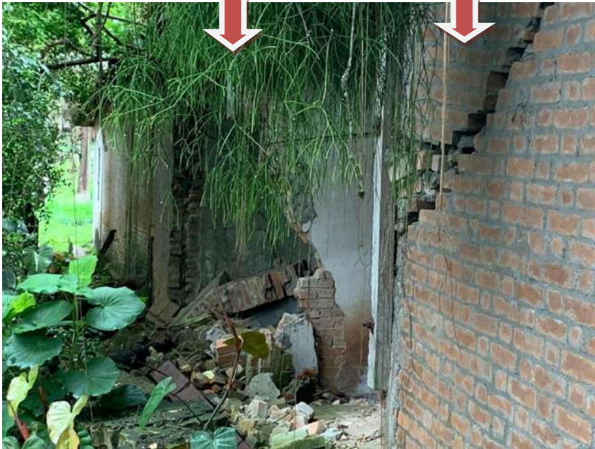
Parede que desabou
