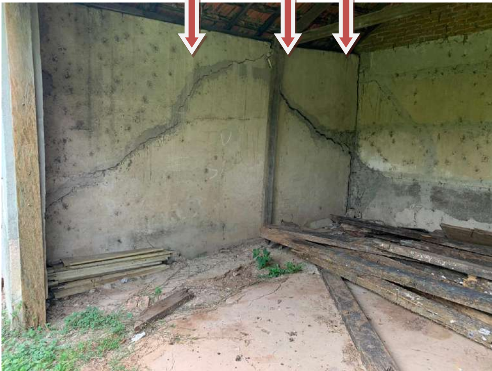
Trincas e rachaduras ao longo das paredes
