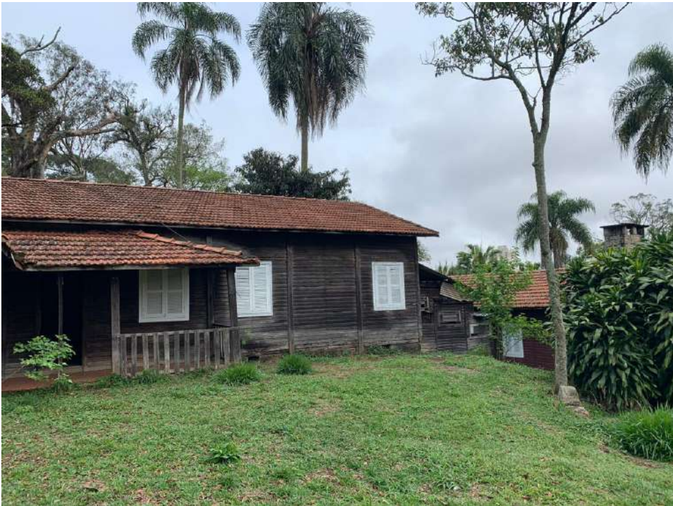
Observam-se problemas na estrutura do telhado; no madeiramento da fachada.
