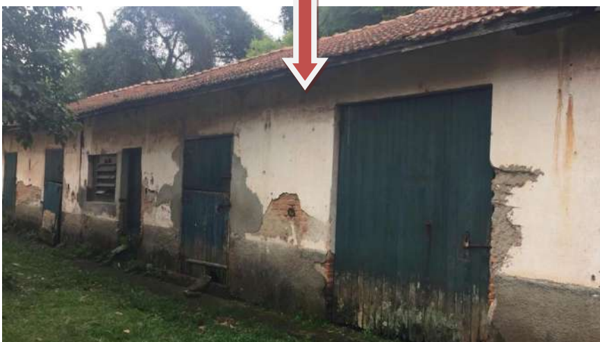
Situação precária dos elementos de cobertura e fachada.
