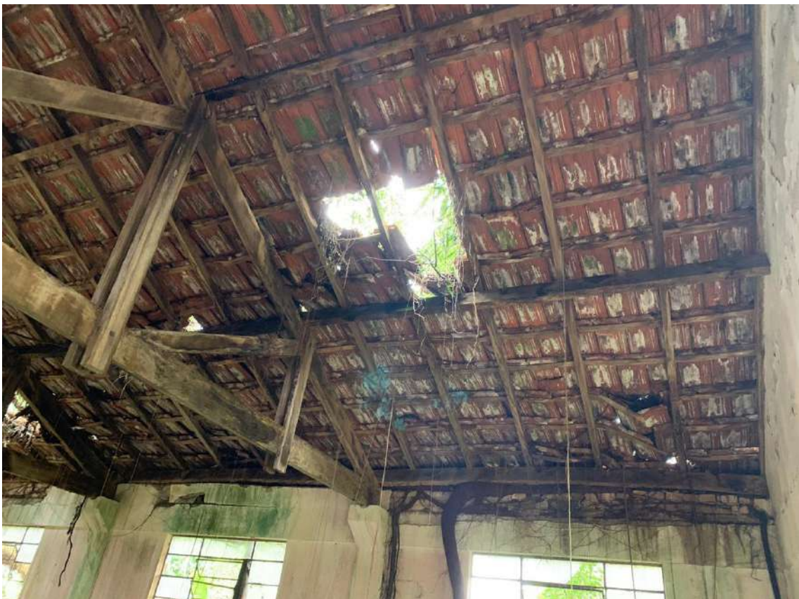
Edificação com problemas na estrutura das paredes, pisos e telhado.
