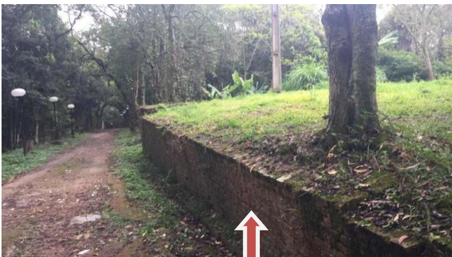
Muro que apresenta inclinação
