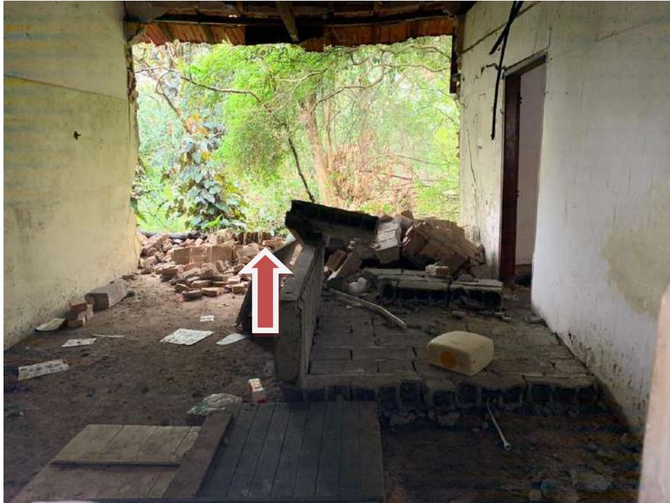
Vista interna da parede que desabou
