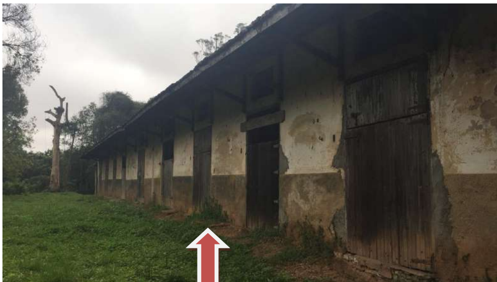
Paredes externas degradadas
