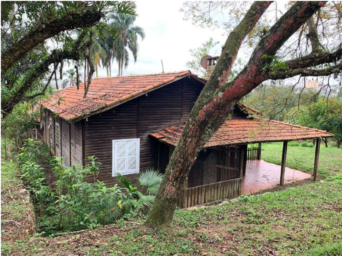
Edificação onde se observa necessidade de serviços de manutenção em vários elementos.
