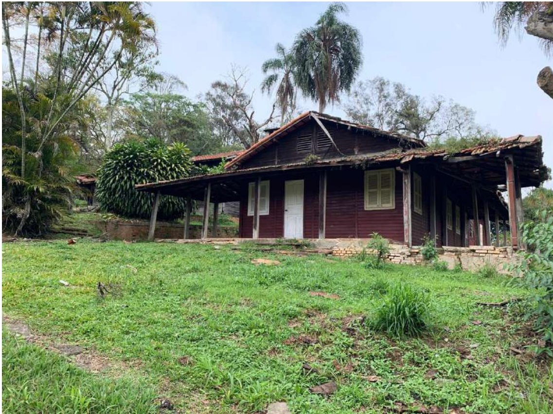
Observam-se, nas fotos acima, problemas na estrutura do telhado
