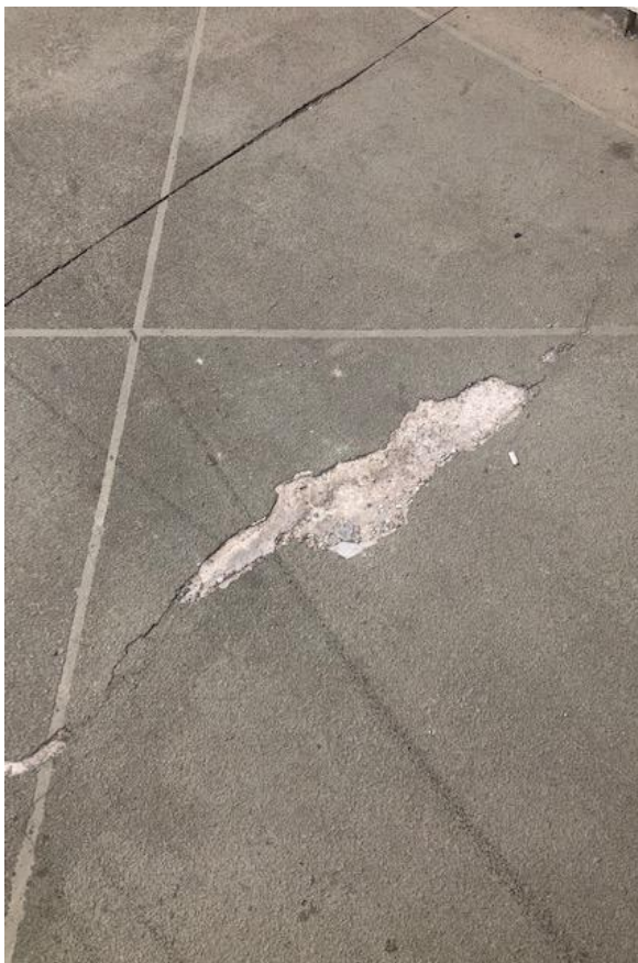
Figura 10 - Camada de revestimento do piso da passarela Luso-brasileira se despregando.
