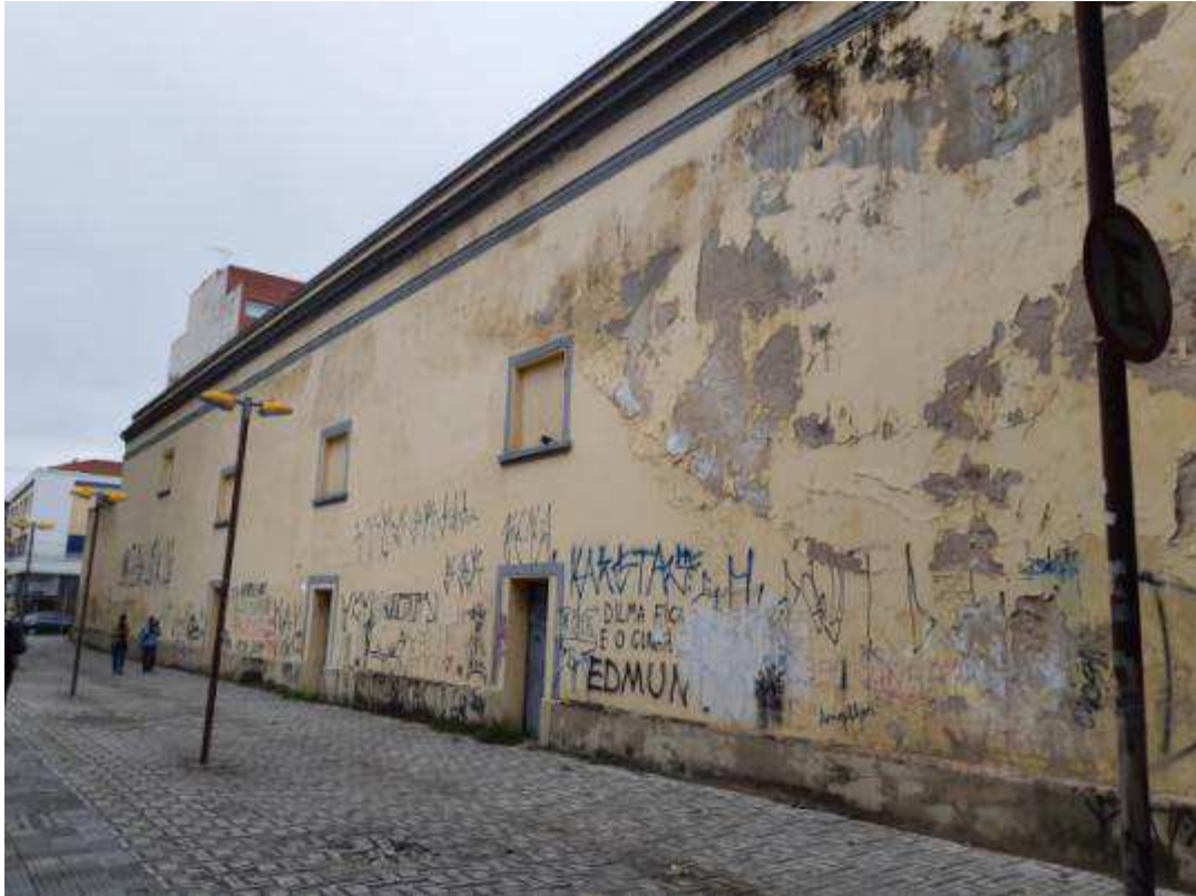
Presença de pichações na parede externa do edifício
