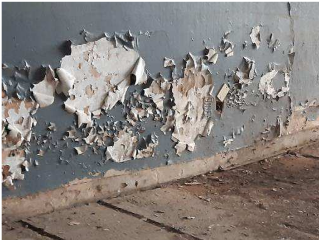
Descascamento da pintura das paredes internas, devido umidade ascendente do solo
