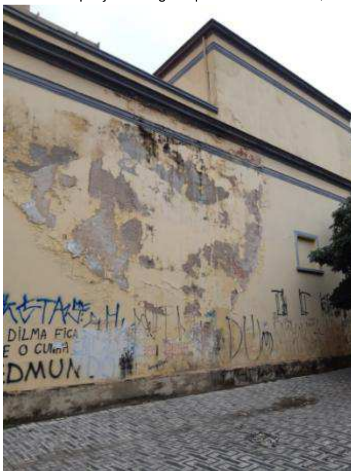
Descolamento de revestimento nas paredes externas em função de infiltração
