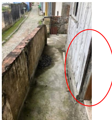
Foto 7: Varanda frontal, notar junção da alvenaria com a madeira.
