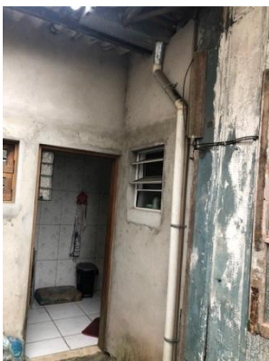
Foto 6: Acesso para cozinha, junção entre a madeira e alvenaria
