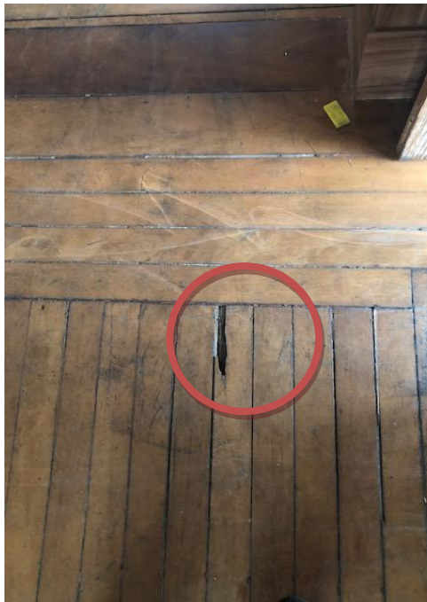
Foto 8 Assoalha com fenda Foto CT 09/04/19.
