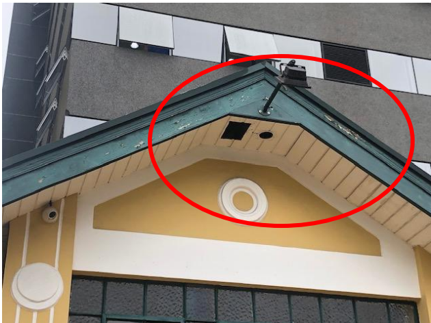
Foto 3 Detalhe Fachada, notar rasgo no beiral. Foto: CT 09/04/19
