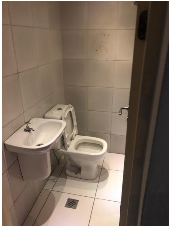
Foto 12 Sanitário instalado no porão Foto CT 09/04/2019.
