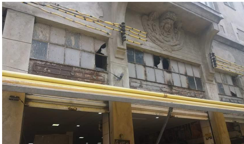
Fiação elétrica na fachada da Av. Bernardino de Campos
