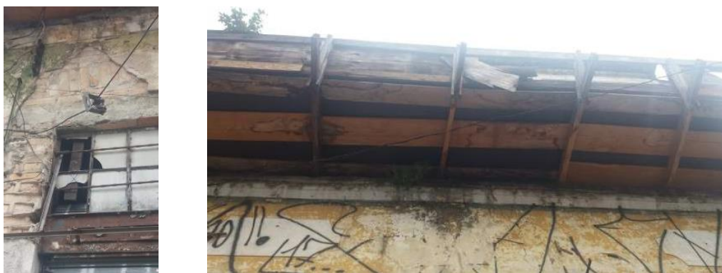
Detalhe do descolamento do revestimento e da deterioração da bandeija na fachada Av. Queirós dos Santos
