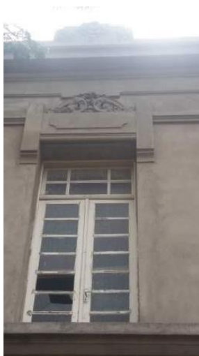
Sacada sem guarda corpo
