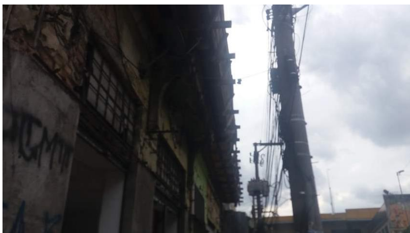
Fiação elétrica dos postes próxima a fachada da Av. Queiroz dos Santos
