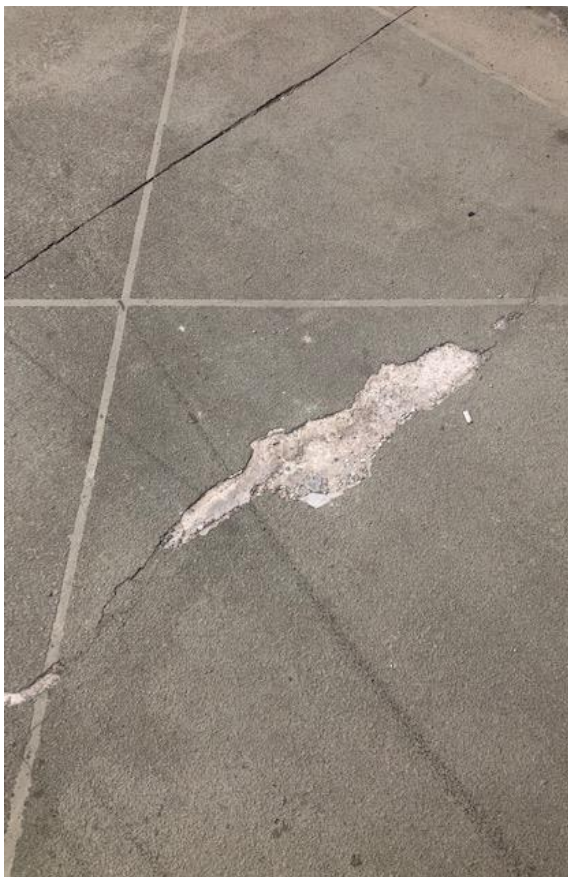
Figura 10 - Camada de revestimento do piso da passarela Luso-brasileira se despregando.
