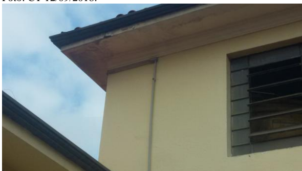
Sinais de infiltração – beiral – fachada lateral esquerda
