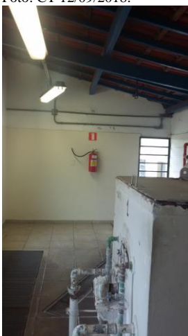
Sala de Dosagem. Foto: CT 12/09/2018.
