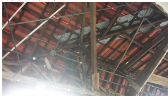
Abertura entre as telhas e estrutura do telhado exposta pela falta de ferro. Foto: CT 12/09/2018.
