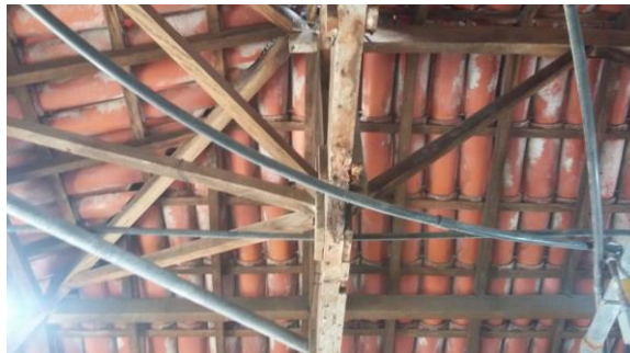
Madeiramento exposto com sinais de ataque de cupim. Foto: CT 12/09/2018.
