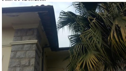
Despregamento do beiral – fachada principal. Foto: CT 12/09/2018.
