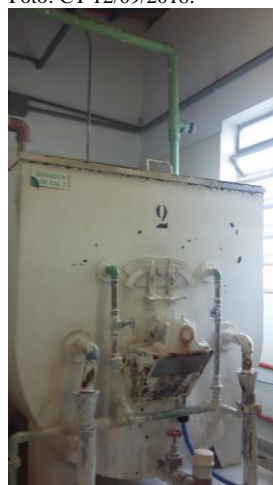
Sala de Dosagem. Foto: CT 12/09/2018.
