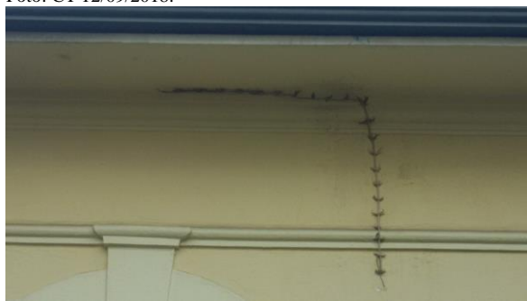
Sinais de umidade e vegetação no beiral e fachada.
