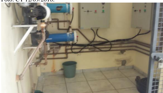
Sala de bombas, umidade e infiltração nas paredes. Foto: CT 12/09/2018.
