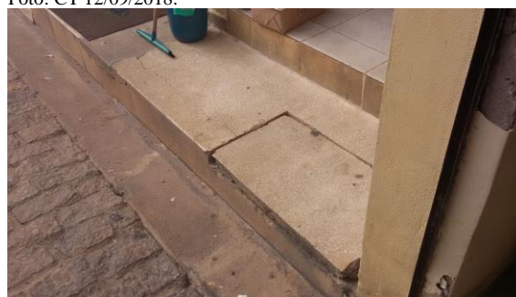
Detalhe do piso de granilite. Entrada para sala de bombas. Foto: CT 12/09/2018.
