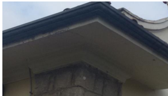
Umidade e rachaduras Foto: CT 12/09/2018.
