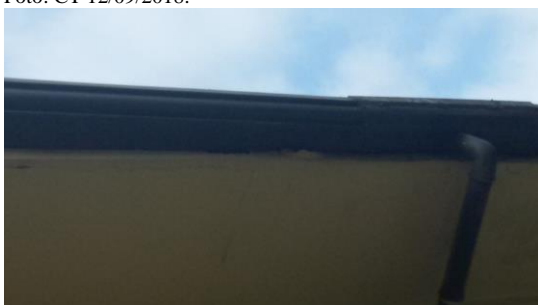
Apodrecimento das calhas fachada principal Foto: CT 12/09/2018.
