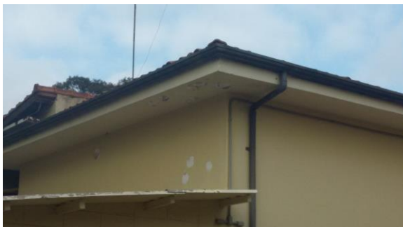
Umidade e apodrecimento das calhas - fachada lateral –esquerda. Foto: CT 12/09/2018.
