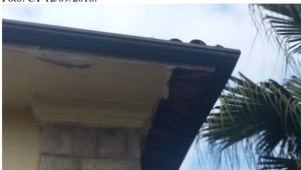
Calhas e beiral com umidade , parte do beiral ruiu e a abertura favorece a entrada de pompos. Foto: CT 12/09/2018.
