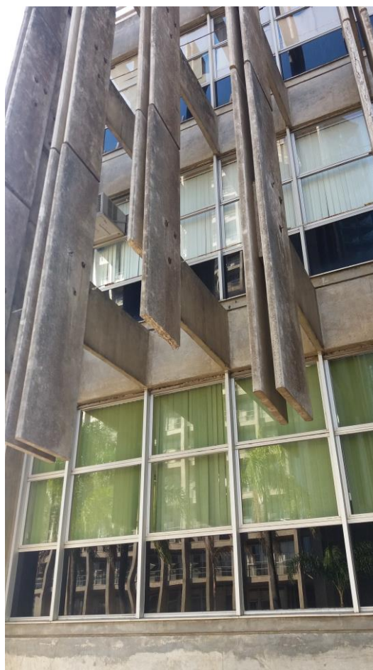
Foto 2. Brises com partes quebradas
