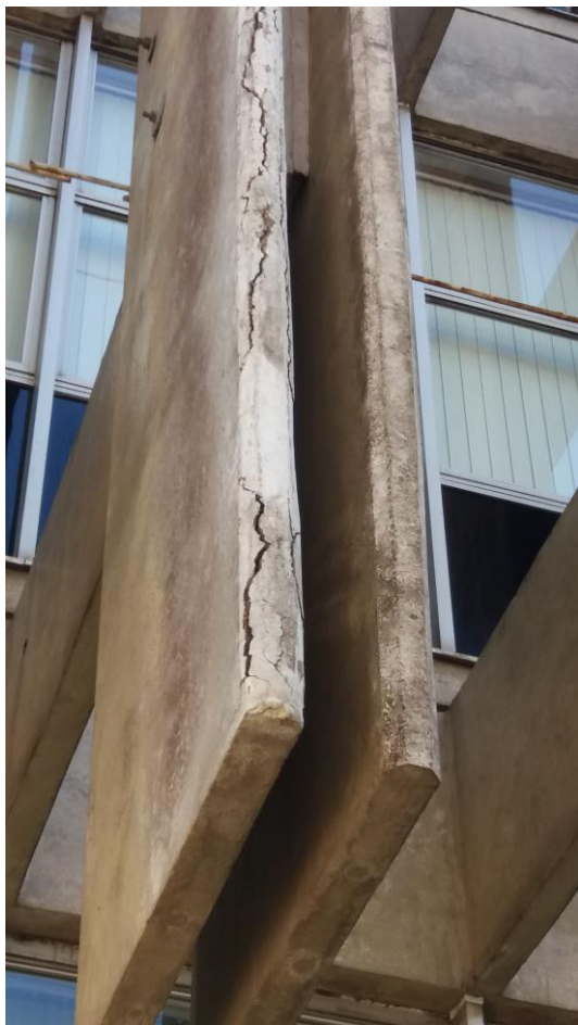
Foto 1. Fissuras e trincas nos brises
