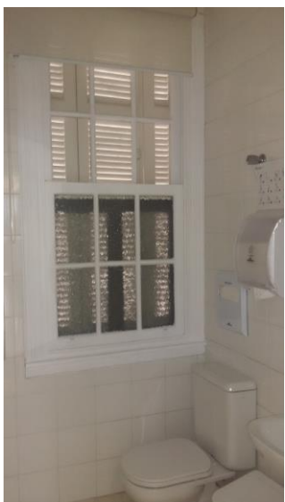
Banheiro pavimento superior Foto CTPC 26/04/2018
