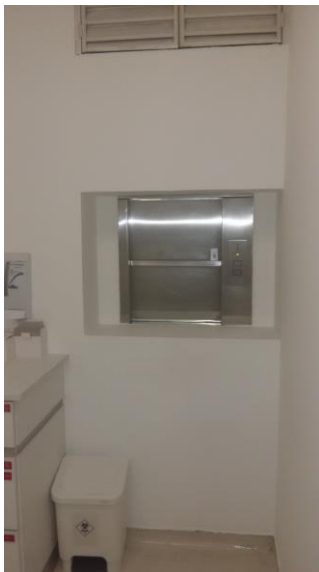
Monta carga instalado na fachada posterior da casa Foto CTPC 26/04/2018
