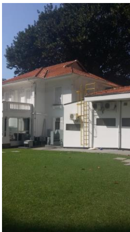
Parte da Fachada lateral direita do casarão e parte do anexo nos fundos do imóvel, pré-existente ao tombamento. Foto CTPC 26/04/2018.
