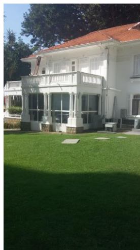
Fachada lateral direita, notar a varanda do pavimento térreo com fechamento para o aproveitamento da área como sala. A varanda já se encontrava com este fechamento quando do tombamento do imóvel. Foto CTPC 26/04/2018.
