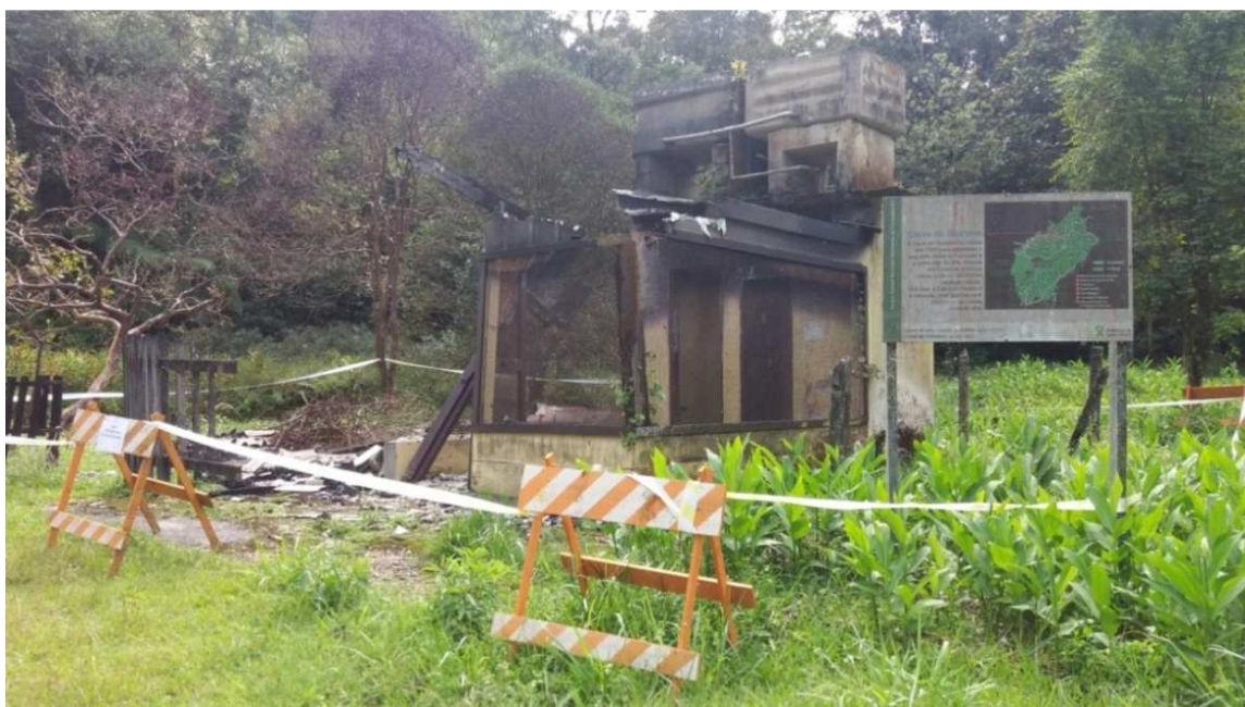
Foto 1: Vista Geral da Edificação após o incêndio
