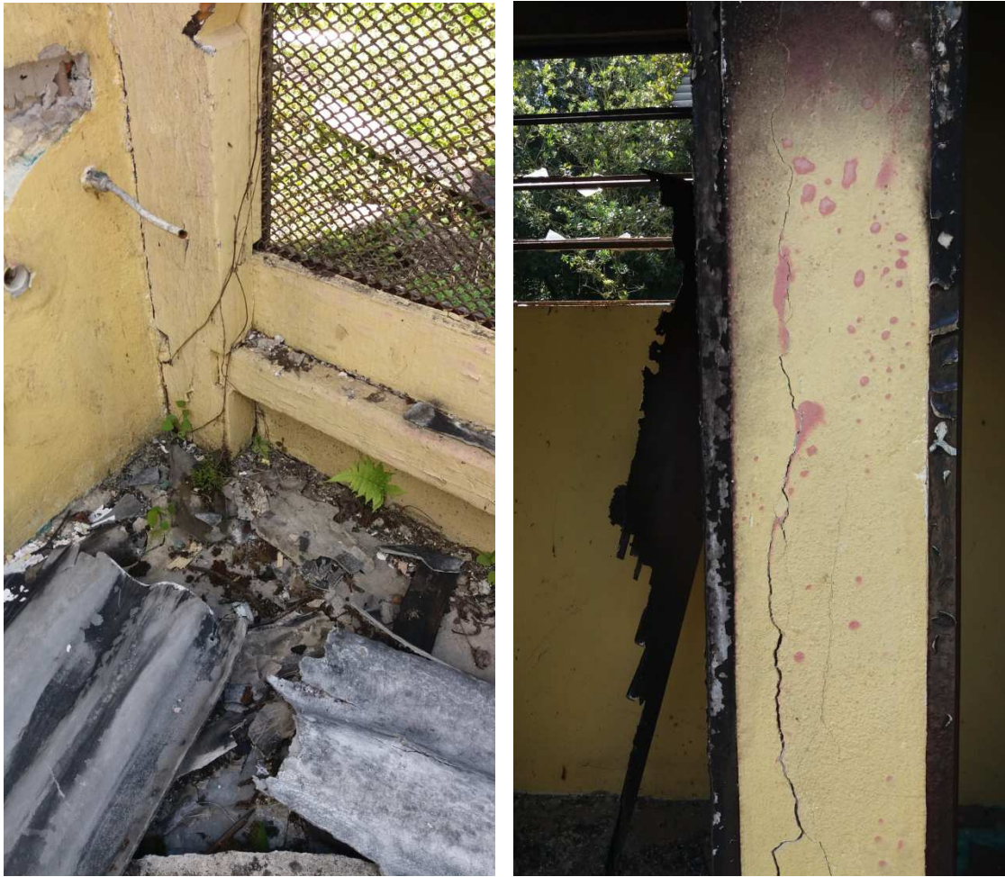
Foto 4 e 5: Detalhes do Anexo em Alvenaria (rachaduras)
